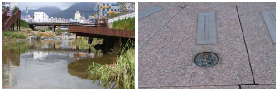
지양 : 급류로 인해 휘어진 전명테크의 기능성 상실 / 날카로운 철골 구조로 안전사고의 위험 노출
