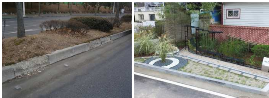
지양 : 노후화 및 시설 관리 미흡 / 각진 모서리 마감
