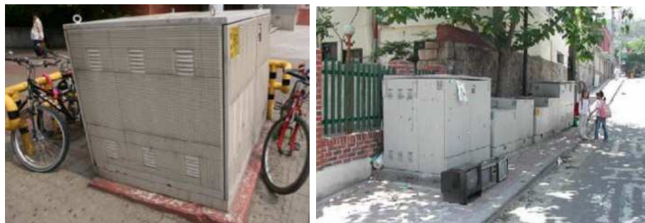
지양 : 배전함이 보행공간을 점유하여 보행자 및 자전거이용자의 동선을 단절시키는 경우
