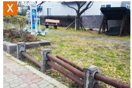
관리가 이루어지지 않는 파손된 시설물
