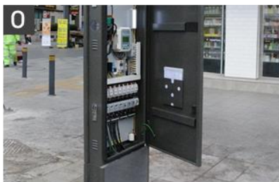
정보안내사인과통합형으로 설치된 가로등 제어함
