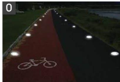
야간 이용자의 안전을 고려한 조명 설치
