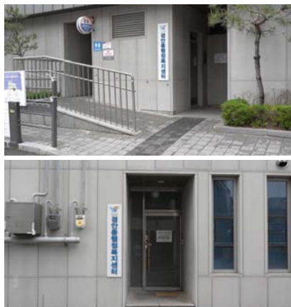
건축법의 무장애 시공위주로 되어 있음 유니버설디자인 차원의 규격, 형태, 재질 필요
