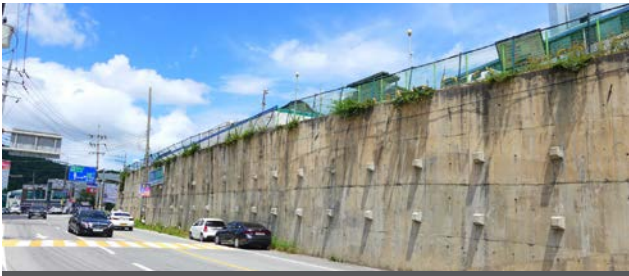
삼동 순암로 옹벽
