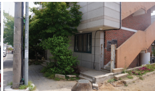
식재 방치로 인한 분명한 시야확보 부족
