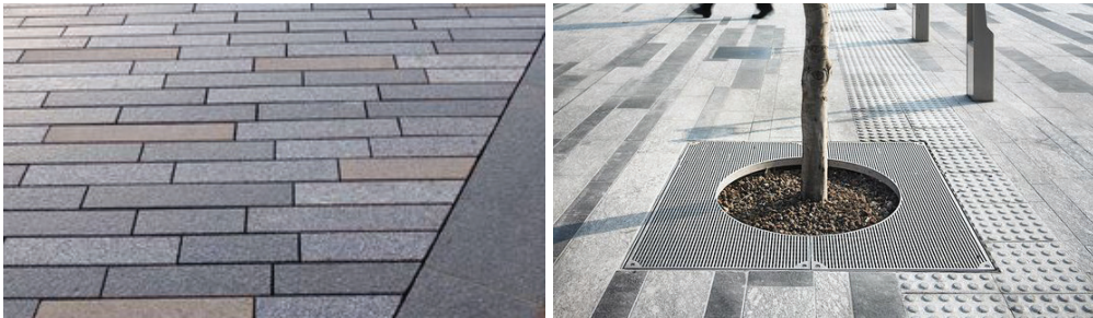
권장 : 중·저체도의 바닥포장과 깔끔한 마감처리로 정돈된 거리환경 권장 : 수목과 닿은 면의 보도블록의 깔끔한 마감처리
