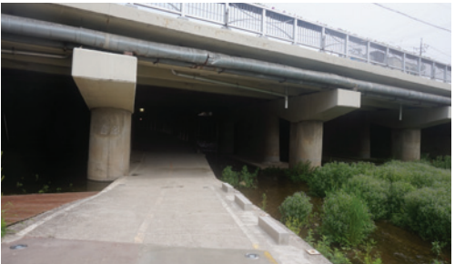
부족한 조명설계로 인해 사각지대 조성
