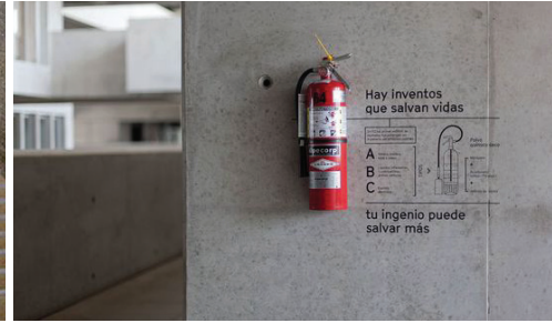
건물 복도에 장애물 없이 설치된 소화기
