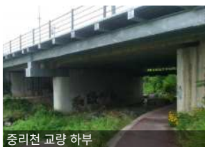
중리천 교량 하부 조명시설 부족과 차폐된 분위기 조성
