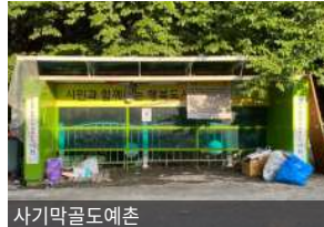
사기막골도예촌 건축물 시설 노후화
