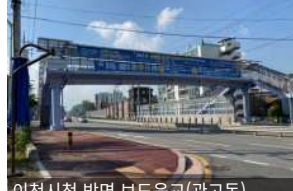
이천시청 방면 보도육교(관고동) 보행약자를 위한 엘리베이터 미 설치
