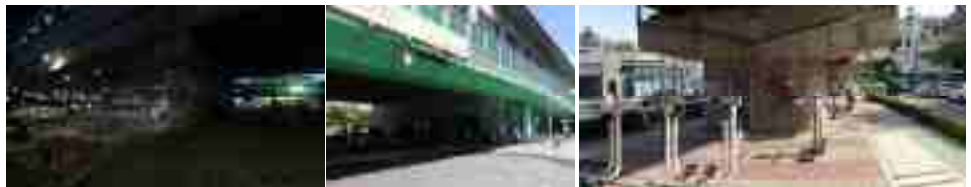
▲ 고가도로 하부공간의 조도가 낮아 우범화가 우려되는 사례 (동구동 / 인창동)
