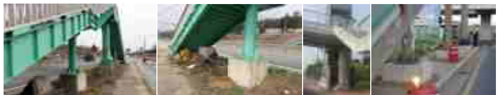
〈그림 4-82 보도육교 하부 콘크리트 기초가 노출된 지양사례 (타 도시)〉
