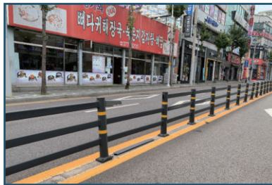
▲ 파손되어 방치되어 있는 중앙분리대
