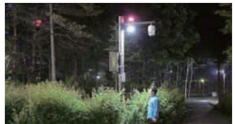
(O) CCTV, 비상벨, 경광등 LED조명이 한 기둥에 모두 연결된 CCTV 통합관제시스템
