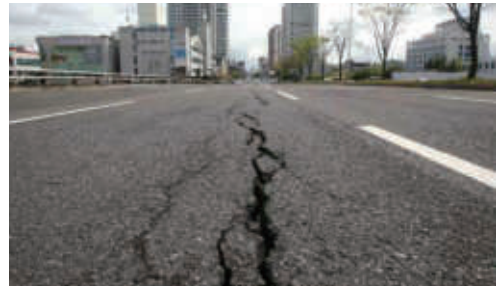
(X) 도로 바닥균열
