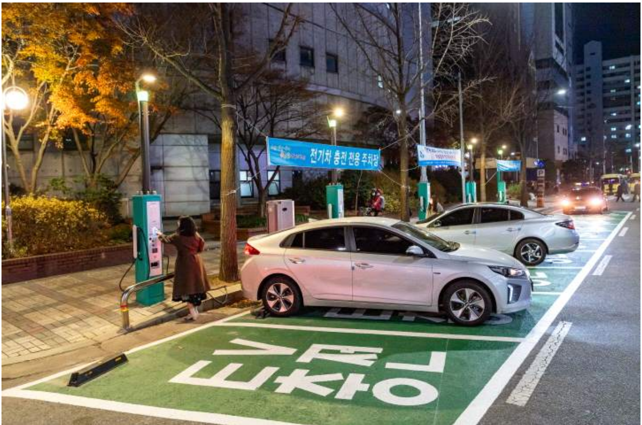
[그림 5-6] 양천구 가로등 활용 전기차 및 스마트 e-모빌리티 충전기 설치 모습
