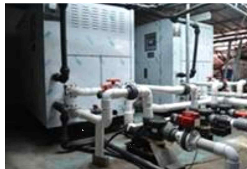
<그림6-32> 양식장 히트펌프 설치
