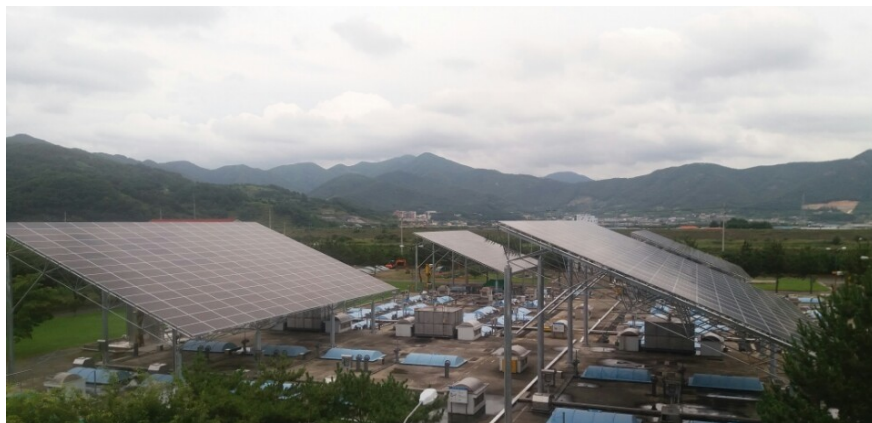
<밀양시 하수처리장 태양광 발전 모습>
