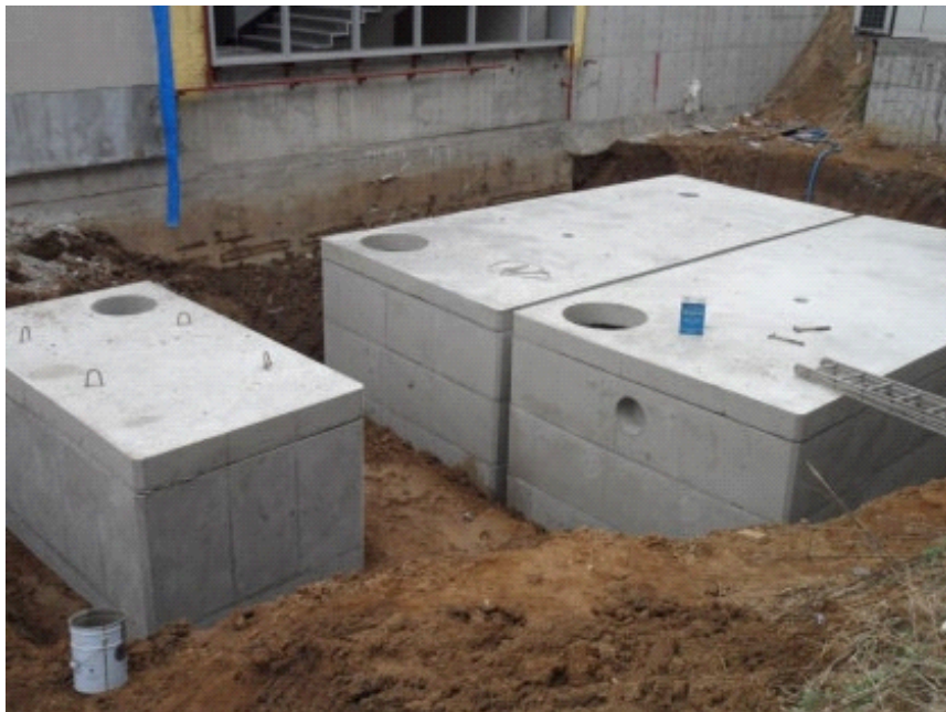
그림 15. 김천국민체육센터 빗물이용시설 설치
