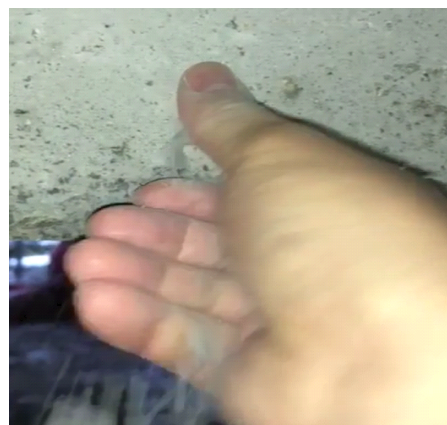
[그림 V-19] 제주시 침단단지내 한 신축건물 보 품질 미확보 (12월 동절기 콘크리트 타설 후 초기동해발생 피해사례)
