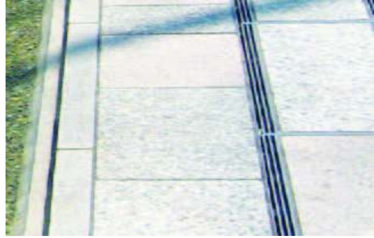
간격이 좁고 바닥마감재와 높이가 동일한 배수로 덮개 설치
