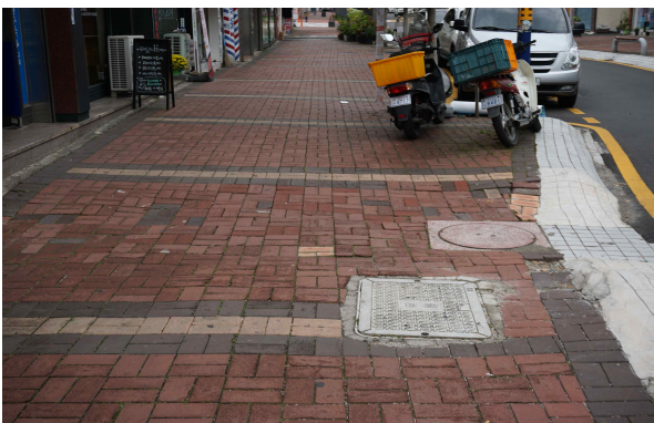
보도의 파손 및 움기 등으로 인한 보행자의 안전을 위협에 대비해 지속적 관리가 중요
