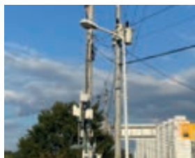
▲ 가로 미관을 고려하지 않고 노출된 통신 설비
