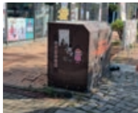
▲ 보도 중간에 설치되었으나 안전 보호 시설 미비
