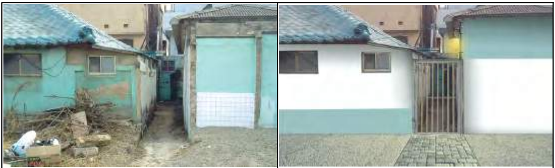
< 그림V-45 건물사이 공간의 출입통제를 위한 시설 설치 >
