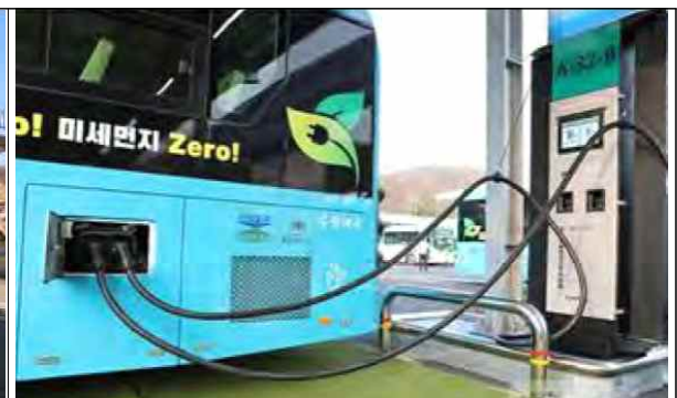
그림Ⅲ.2.22. 수원시 전기버스 및 차고지내 충전시설
