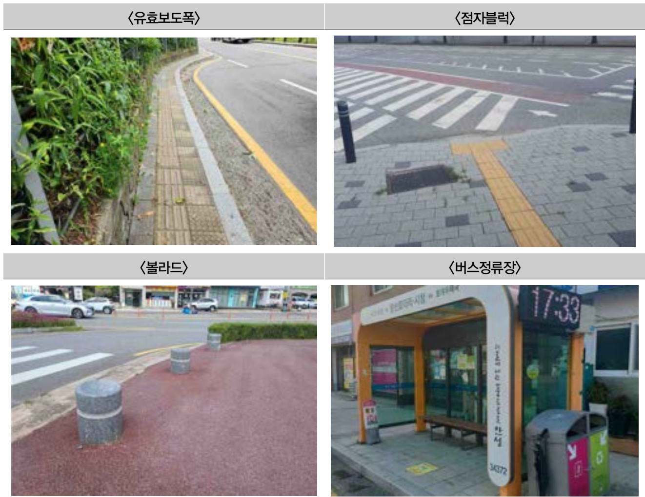
〈그림 5-4〉 이동편의시설 부적합 사례
