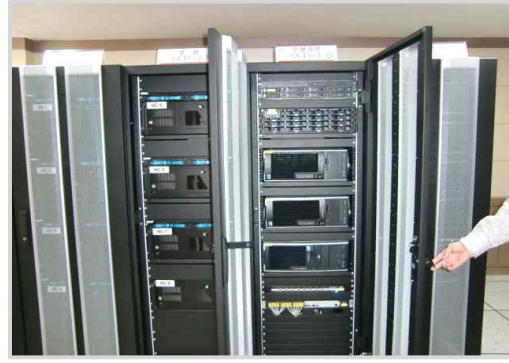
[그림 II-47] 방범CCTV 관제센터 장비실
